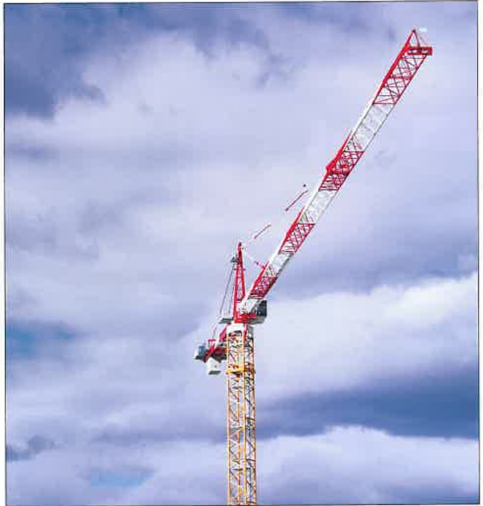
Prototipos de la nueva MD 560 B están trabajando en un proyecto de ampliación en la estación de ferrocarril Atocha de Madrid, España.
